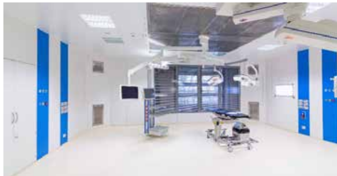
Figura 16.24 - Sala operatoria Ospedale di Chioggia – Sistema TrueSpace di Operamed
