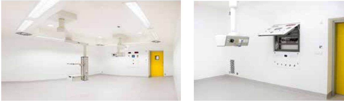
Figura 16.8 - Ospedale Universitario de La Coruña – vista generale della sala e dettaglio della zona dei terminali e del quadro comandi
