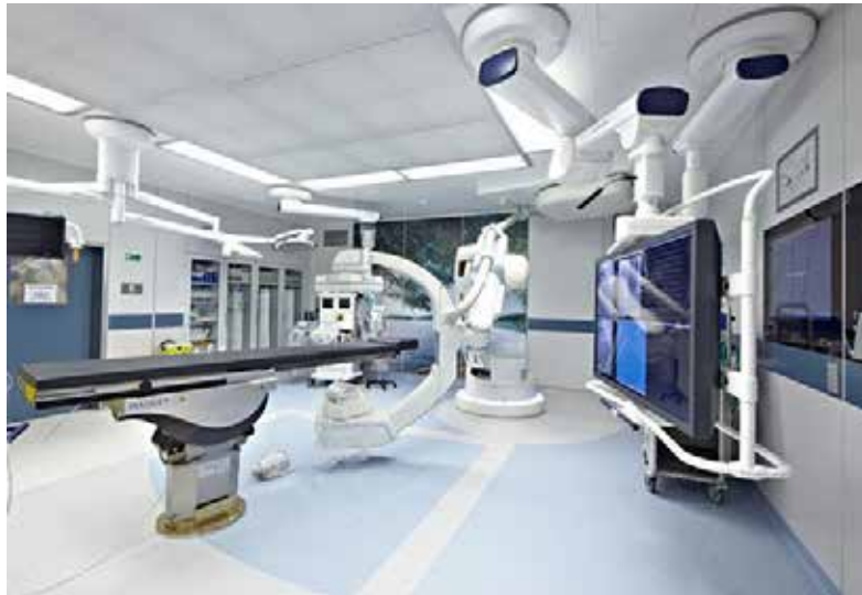
Figura 9.12 - Sala ibrida con arco a C robotizzato a pavimento - Valley Private Hospital, Melbourne, Australia, 2012
