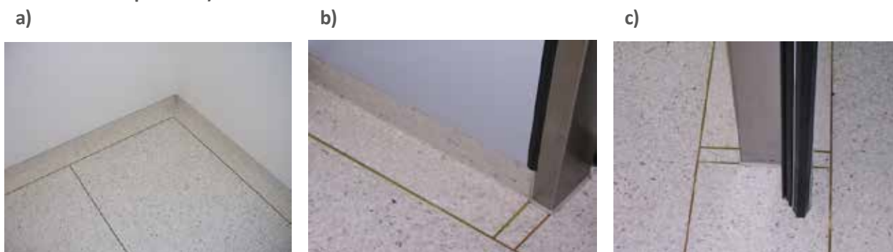
Figura 16.4 - BG Klinik Ludwigshafen di Francoforte – a) Dettaglio della zona d'angolo - b) ; c) Dettaglio della zona della porta - c)
